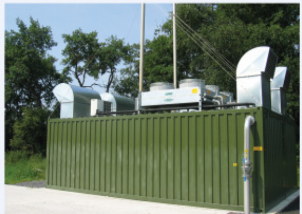
Schallschutz mit Be- und Entlüftung für ein Stromaggregat
